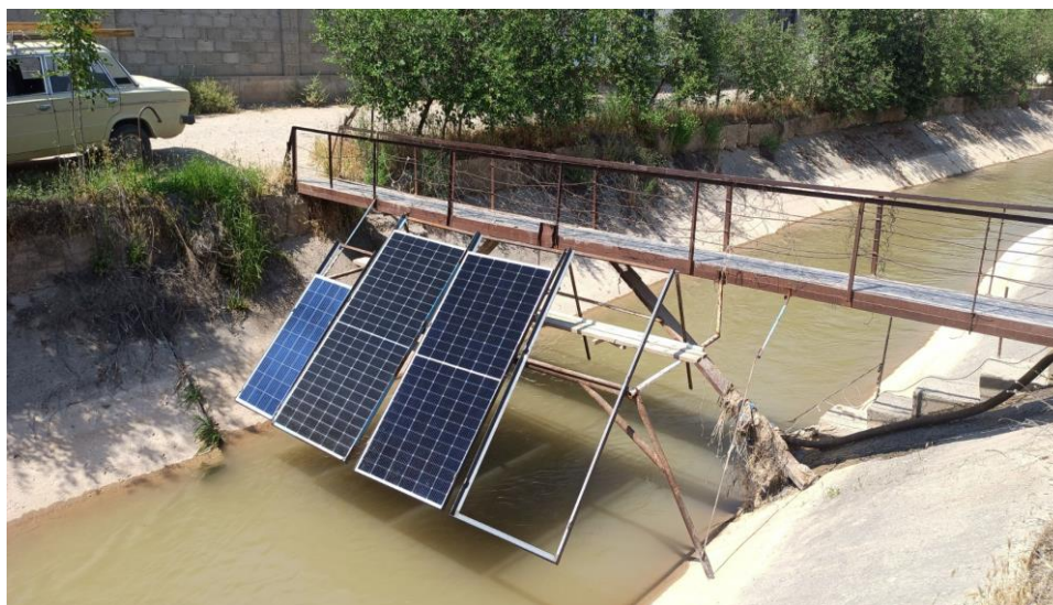
Rasm 3. Kanal ustidagi quyosh panellarining umumiy joylashuvi.
